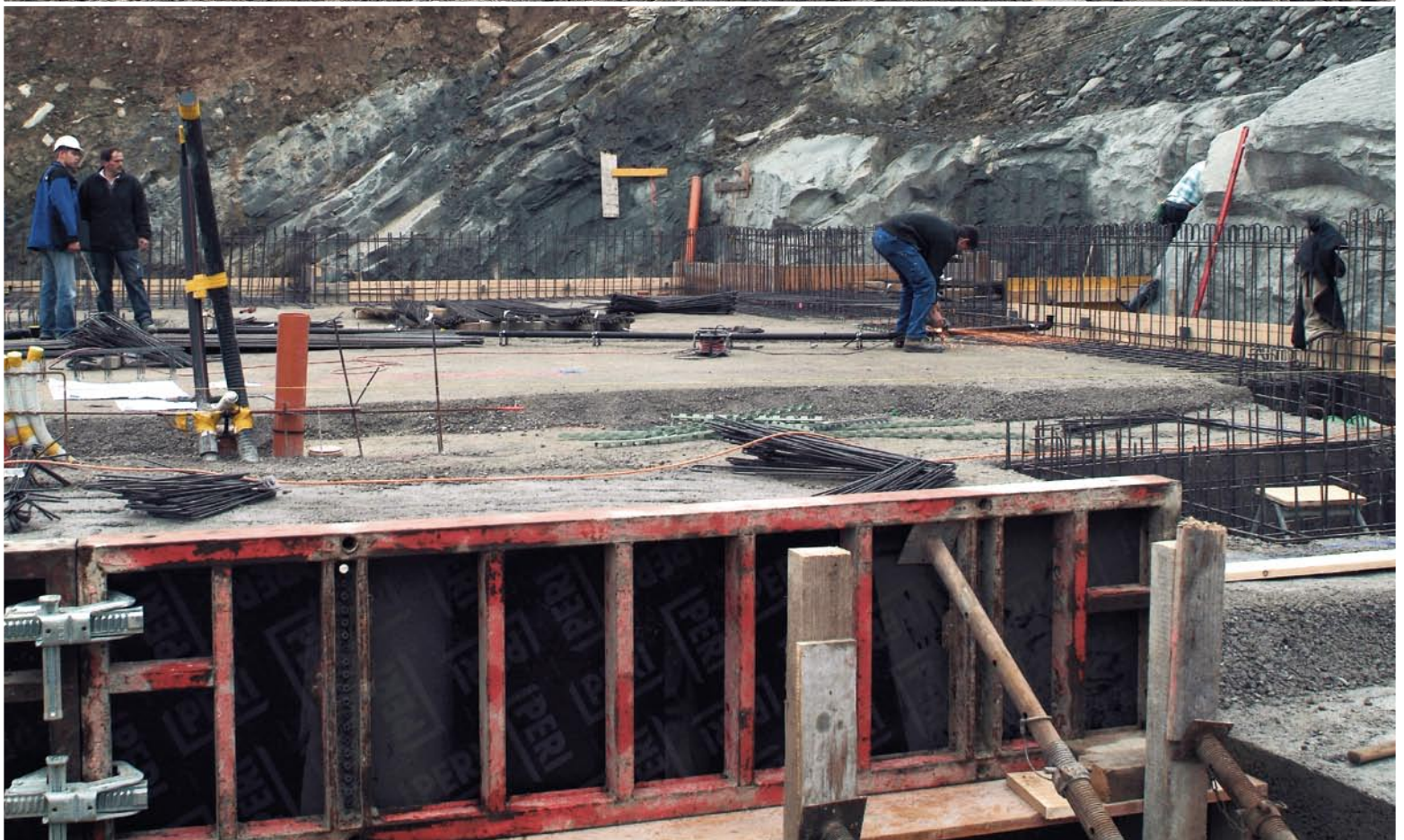
Blick auf die gesicherte Baugrube, in welcher nun die Arbeiten am Fundament zügig voranschreiten. Hier sind auch die Elementschalungen gut zu sehen, die für die Betonierung der ersten Seitenwände benötigt werden. Nachdem die ersten Mauern hochgezogen worden sind, werden nun die ersten Deckenarbeiten ausgeführt. Damit die statischen Vorgaben erfüllt werden, müssen die Eisenleger an vordefinierten Stellen Armierungseisen einsetzen.
